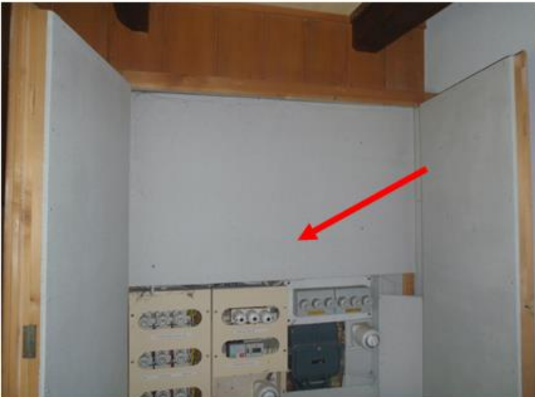
Asbestkarton in Sicherungskasten
