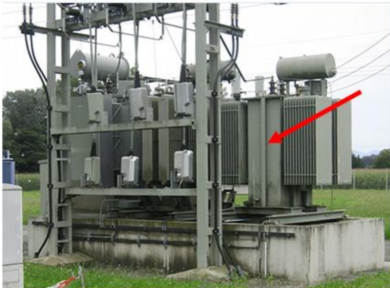
Kühlmittel in Transformatoren
